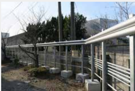
送液管(エポキシ樹脂とウレタン樹脂)
